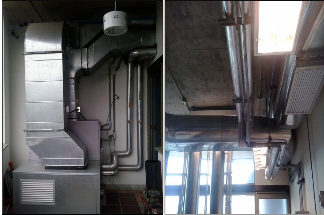
Figura 19. Sistema de aire acondicionado integral
