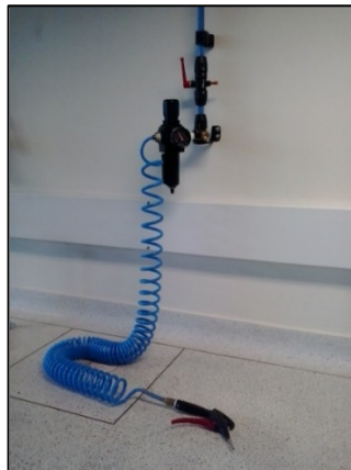
Figura 18. Conexión y regulador de aire comprimido
