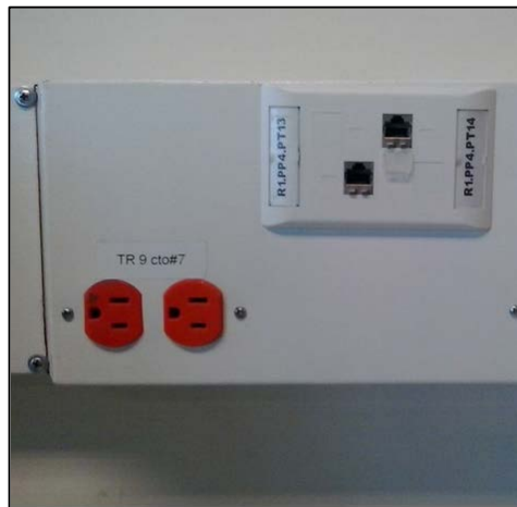
Figura 20. Toma corrientes auxiliares
