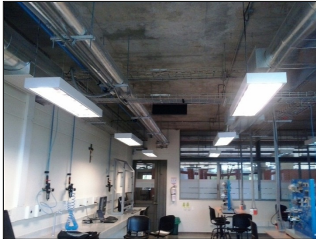
Figura 21. Sistema de iluminación del modulo
