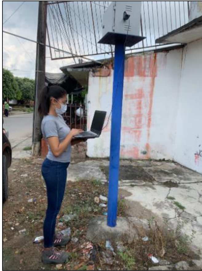
Fig 37 Toma de datos de presión en transmisor barrio el dorado
