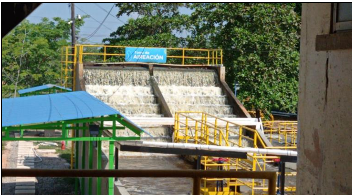
Fig 4 Sistema de aireación planta de tratamiento
