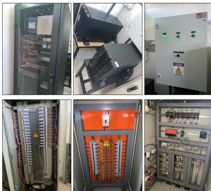
Fig 27. Equipos zona del servidor
