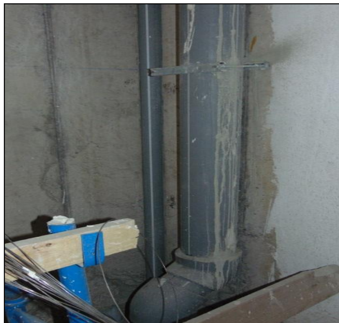
Imagen 1. Red matriz agua potable (Desde subterráneo -2, hasta piso 8); Edificio Roble III
