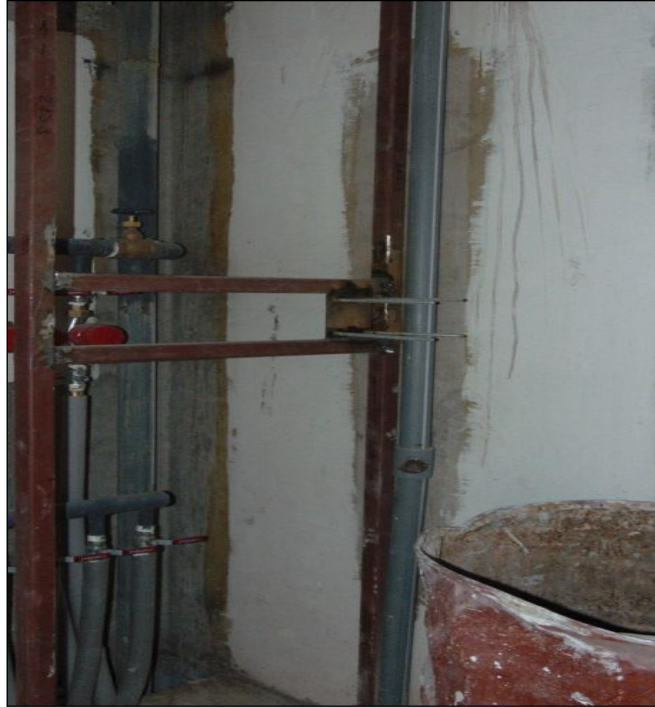
Imagen 4. Estructura de instalación gabinete para red de incendios; Edificio Tineo I & IV
