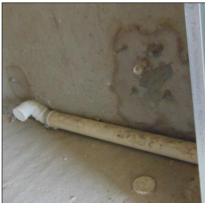
Imagen 2. Descarga horizontal Alcantarillado, Edificio Roble III
