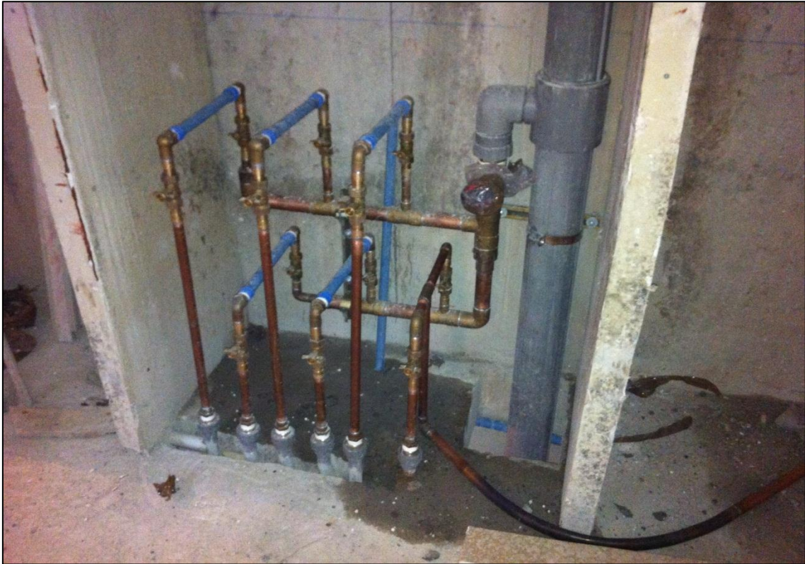
Imagen 14. Red de distribución de Agua potable, fría, interna domiciliaria por cada piso
