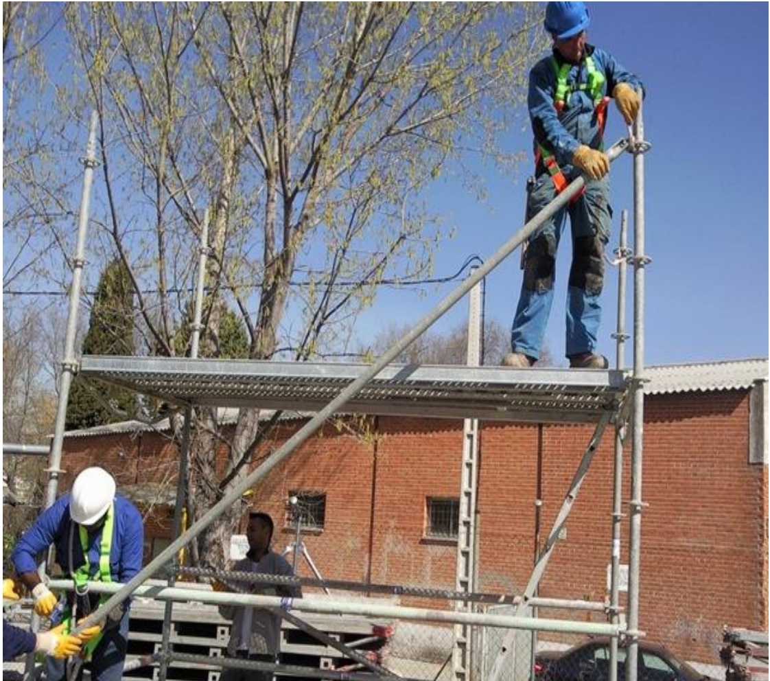
Imagen 17. Ejemplo de equipo Andamio tubular.
