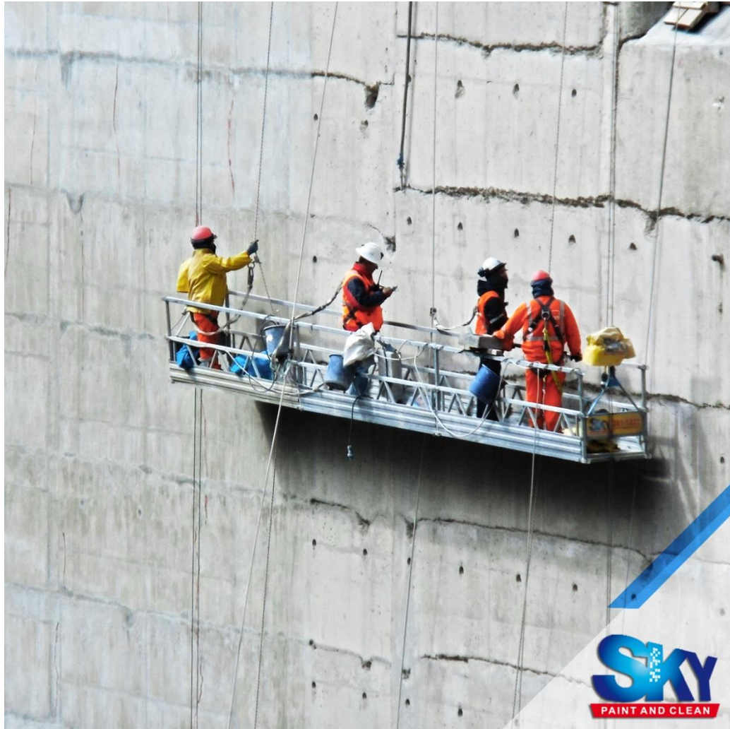
Imagen 16. Ejemplo de equipo Andamio colgante.
