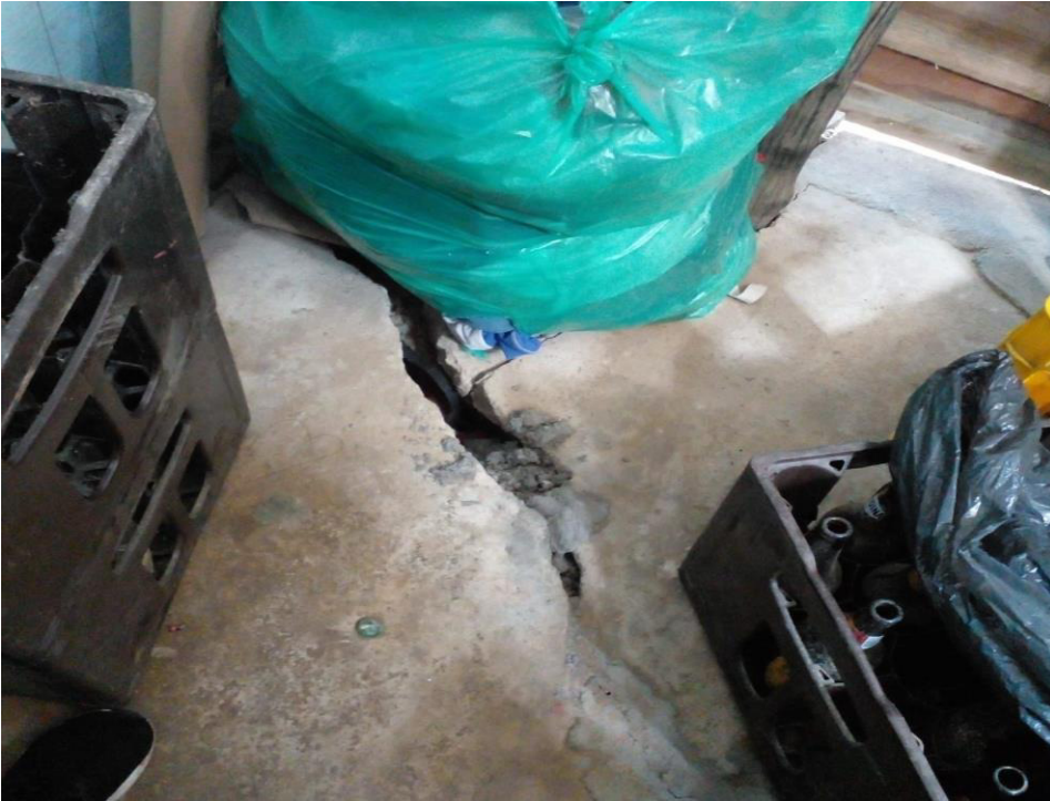
foto 11 Deslizamiento Unidad Productiva- Villas de Girardot 24 octubre 2022
