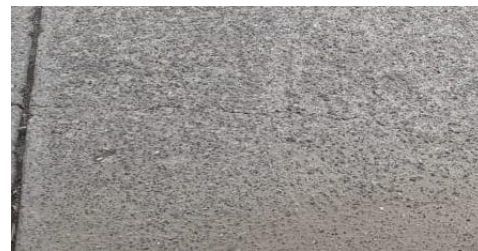
Figura 14. Fisura de contracción en la Unidad 6.
