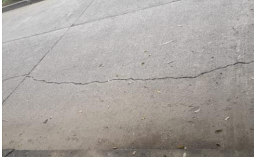
Figura 10. Fisuras lineales en la Unidad 8.
