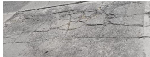
Figura 13. Punzonamiento de alta severidad en la Unidad 3.
