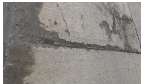
Figura 16. Descascaramiento de junta en la Unidad 13.
