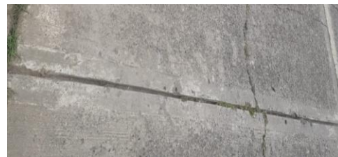
Figura 9. Daño en el sello de junta.
