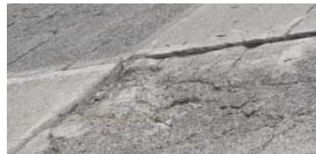
Figura 15. Descascaramiento de esquina en la Unidad 3.
