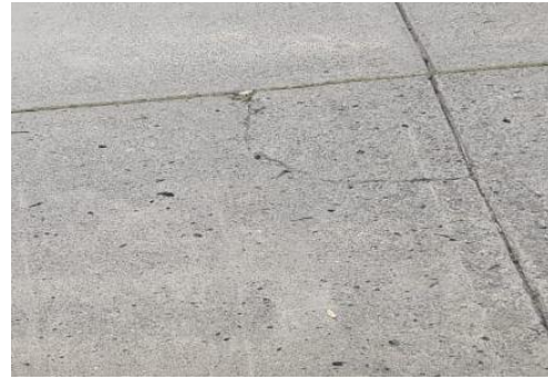
Figura 7. Fisura de esquina en la Unidad 10.
