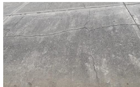
Figura 8. Losa dividida en la Unidad 3.
