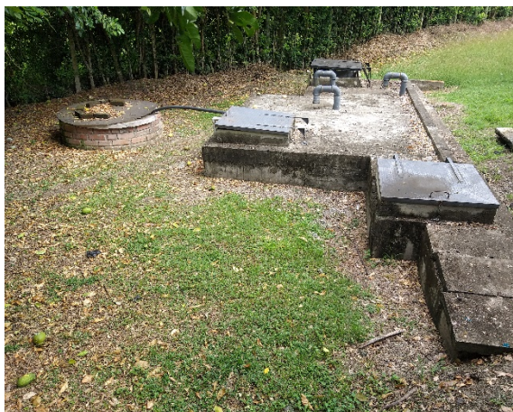
Foto 6. Tanque recolector y pozo profundo. Fuente: propia.
