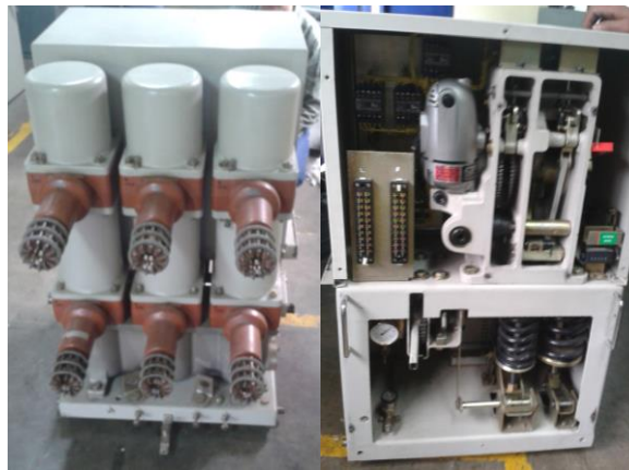
Figura 6. Interruptor de Gas SF6 Mitsubishi de la central.
