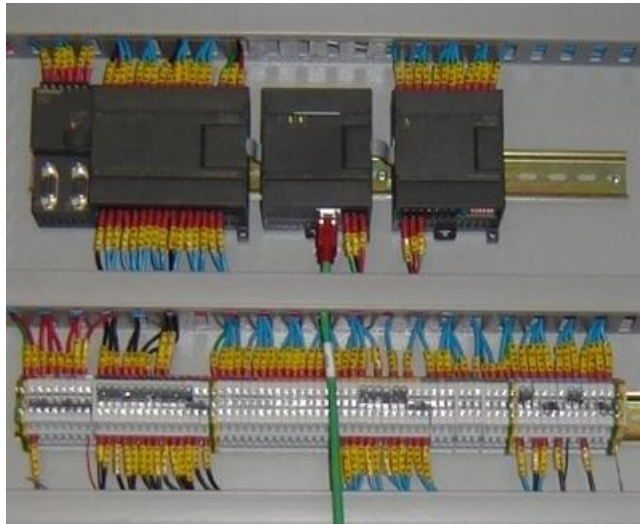
Figura 28: Imagen del Hardware del Sistema de Control
