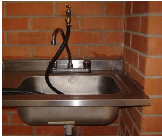
Figura 4: Llave de Paso para el Sistema de Humidificación
