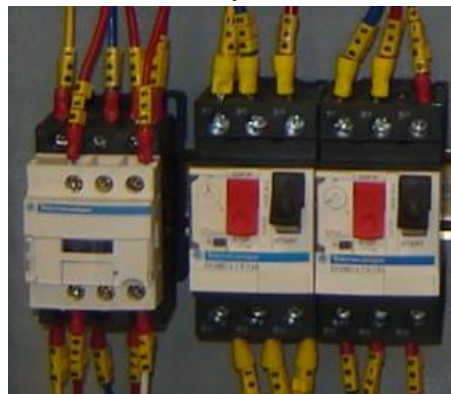
Figura 16: Guardamotores del Motor Trifásico y Monofásico a 220 VAC
