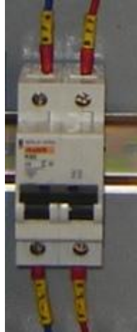
Figura 17: Breaker Bipolar para la Fuente SITOP
