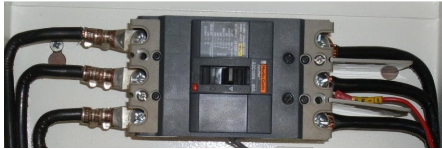
Figura 12: Interruptor Totalizador del Tablero de Automáticos
