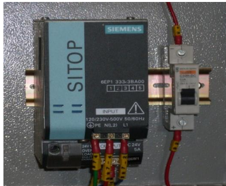
Figura 18: Breaker Unipolar para Protección de la Línea +24 VDC
