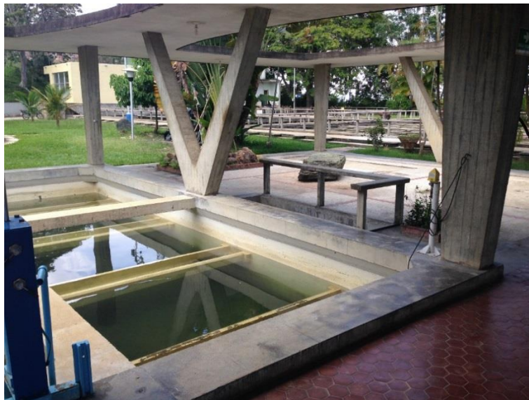
Figura 11. Filtro para potabilización de Agua.
