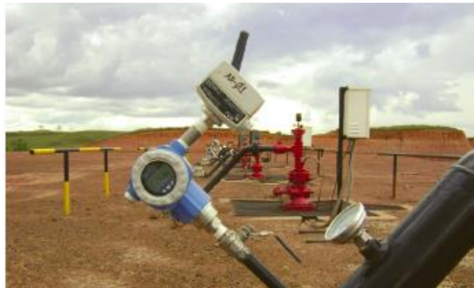
Figura 14. Equipos instalados en campo
