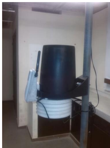
Ilustración 35. Sensores de la estación
