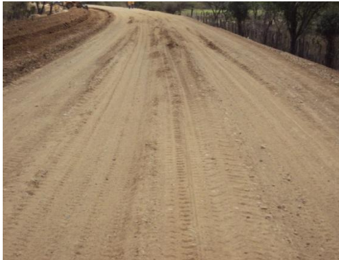
Imagen 4: Fallos presentados por la saturación del material de subbase
