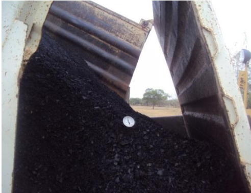
Imagen 8: Medición de la temperatura de la mezcla asfáltica que llega a la obra
