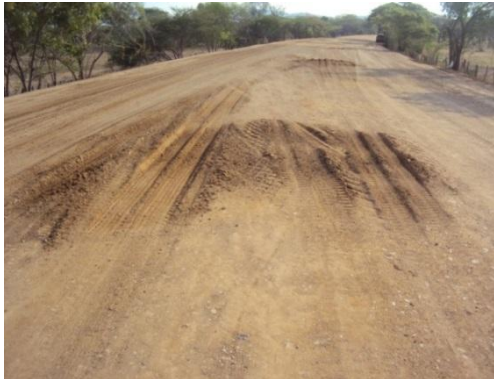
Imagen 1: Fallos presentados por la saturación del material de terraplén
