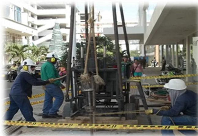
Imagen 4. Sondeo 3, carrera 8 con Avenida Santander. Se observa el equipo de perforación al fondo. En el momento de la fotografía se realiza el ensayo de penetración estándar (Autor).
