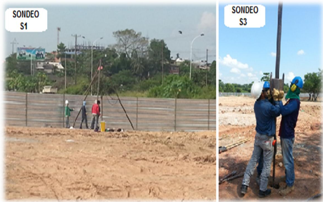
Imagen 12. Ensayo SPT algunos de los sondeos localizados para el desarrollo de la vía (Autor).
