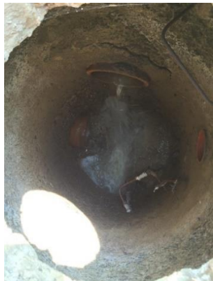
Fuga pozo Alcantarillado
