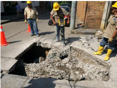
Hundimiento vía Cra 10 con 9
