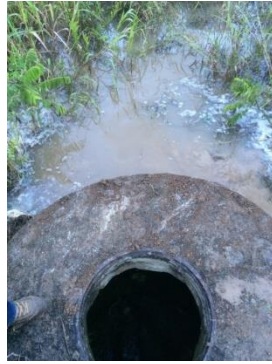
Pozo sin tapa
