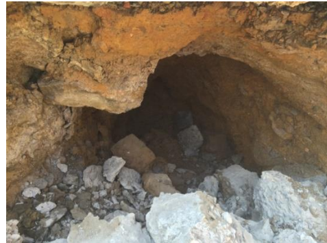
Socavamiento del terreno
