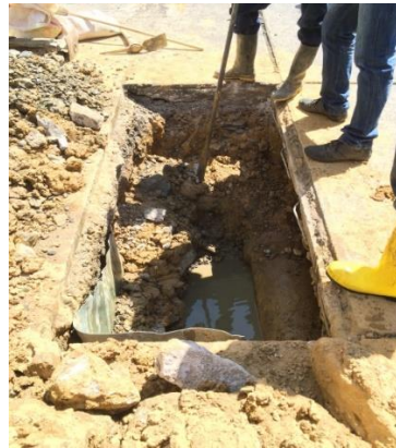
Tubería rota de Gres
