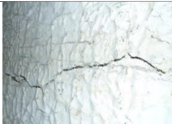
Figura 23. Fachada de vivienda Asentamiento Informal Urbanización las Olas.
