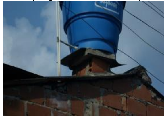
Figura 21. Tanque elevado, Asentamiento Informal Urbanización las Olas.
