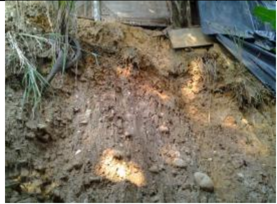
Figura 35. Talud erosionado Villa María
