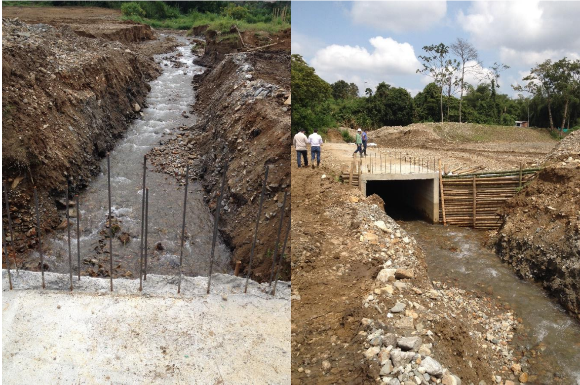
Figura 28. Box Coulvert en funcionamiento. Fuente Propia
