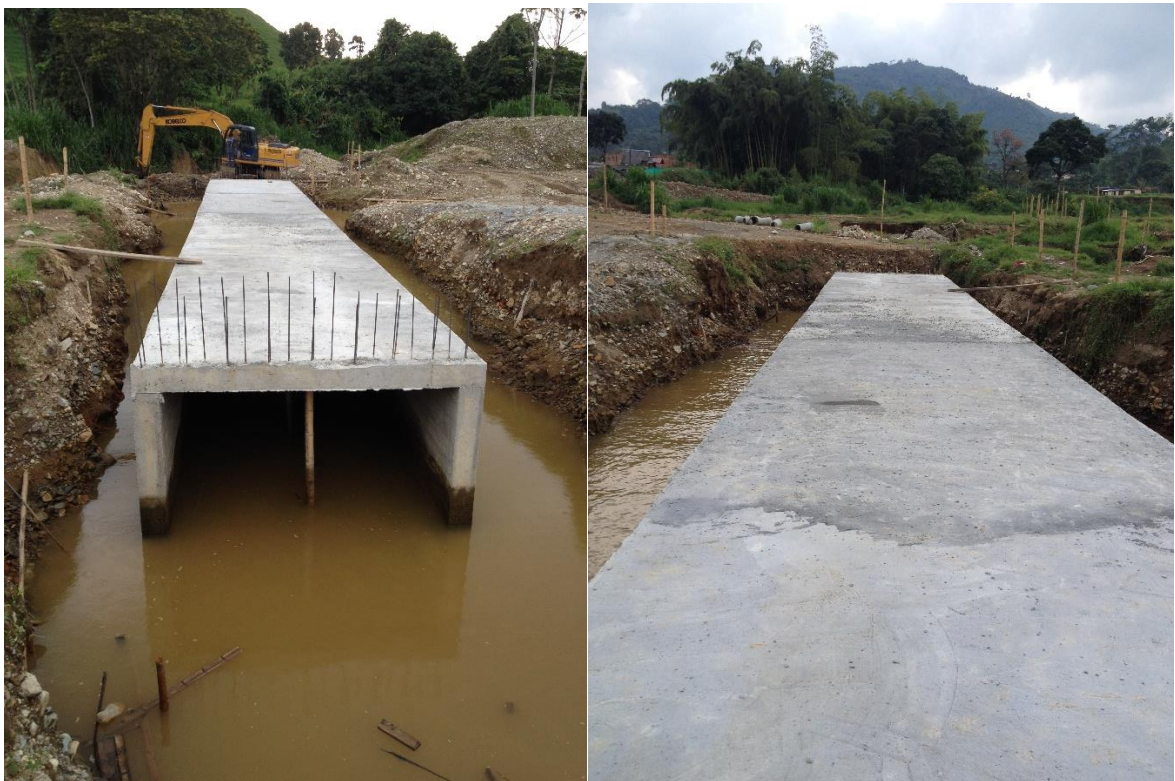
Figura 25. Box Couvert Inundado. Fuente Propia
