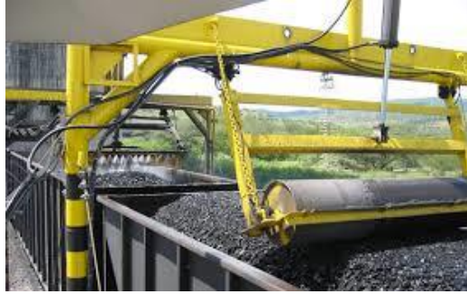
Figura 2. Cargue de carbón en los silos. Nivelación de la carga
