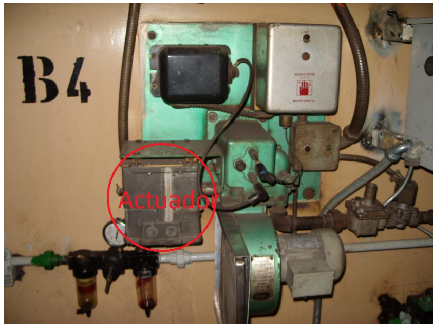
Fotografía.15. Quemador instalado en el archa
