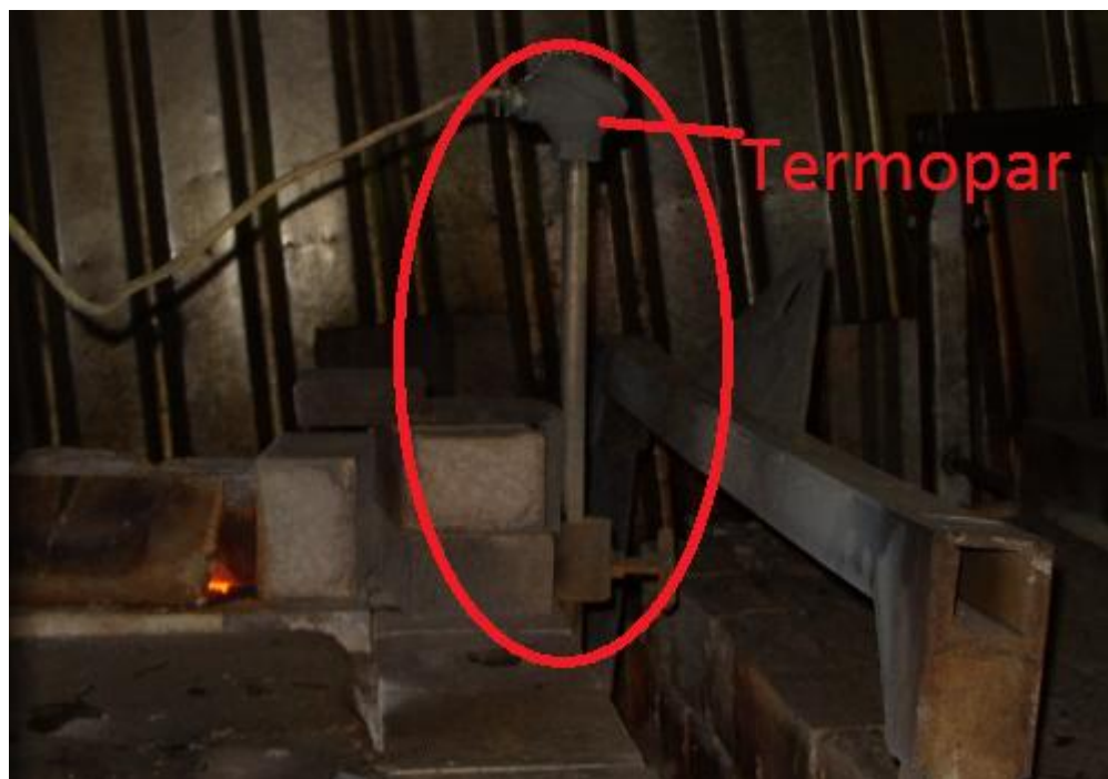
Fotografía.16. Termopar instalado en un alimentador
