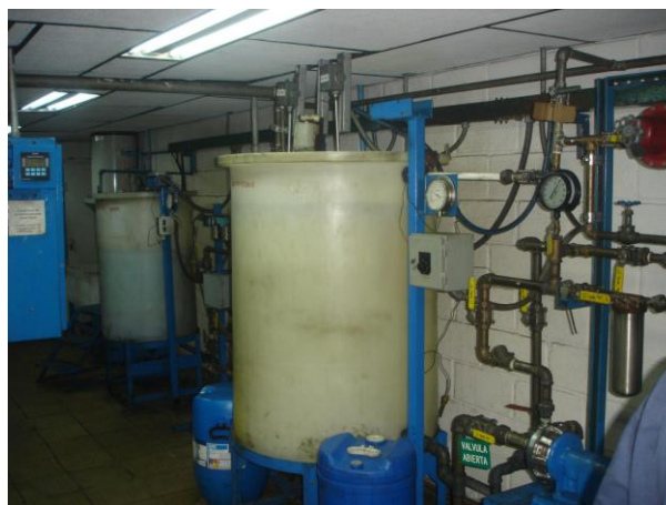
Fotografía. 5. Sistema de Mezcla de agua de tijeras en un inicio antes de modificarse el tanque del frente es el de la mezcla, el del fondo es el del biosol.
