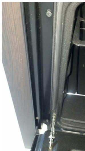
Foto 15. Horno a gas empotrado al mueble de madera de la cocina.
