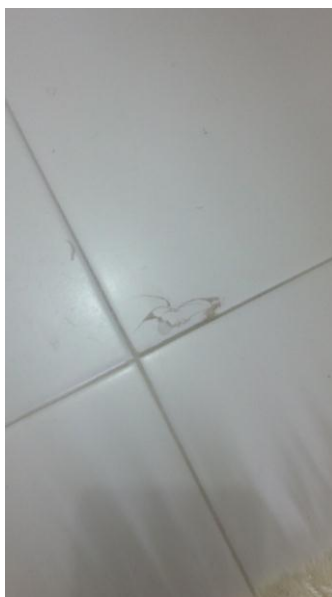
Foto 6. Losa de piso desportillada.
