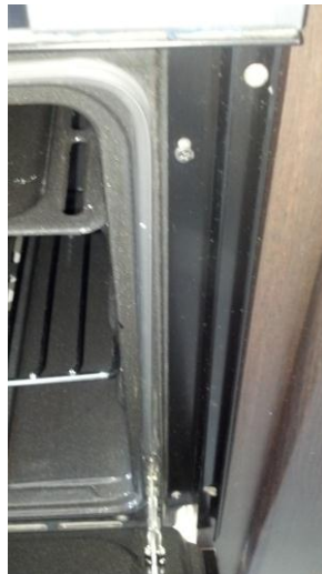
Foto 20. Horno a gas empotrado al mueble de madera de la cocina.
