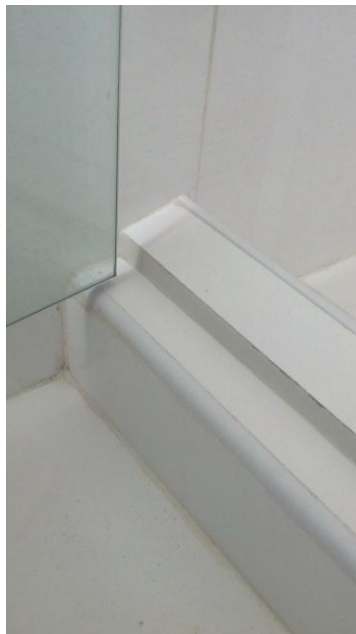
Foto 10. Bordillo de piso para división de ducha con cerámica lineal instalada en la cara superior
