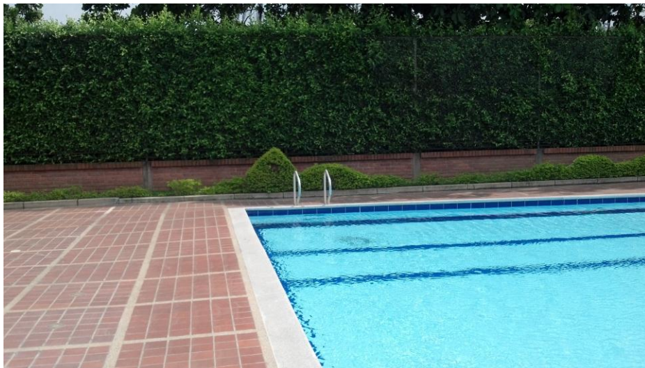
Foto 27. Terraza de piscinas con asentamiento.
