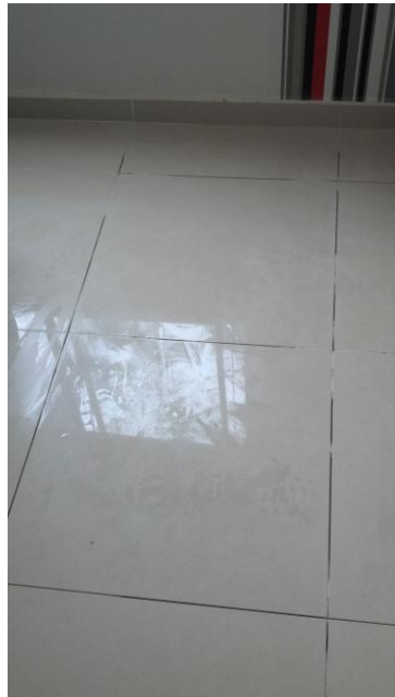
Foto 3. Losas cocas con la bindaboquilla retirada.
