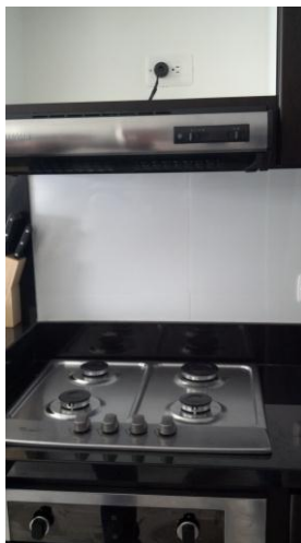
Foto 16. Cable de conexión eléctrica a la vista. Equipo: campana extractora.
