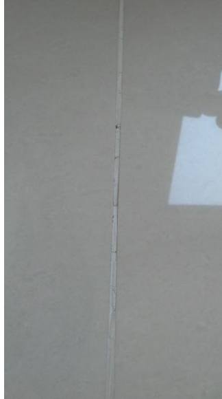
Foto 7. Bindaboquilla fisurada de la brecha del porcelanato.
