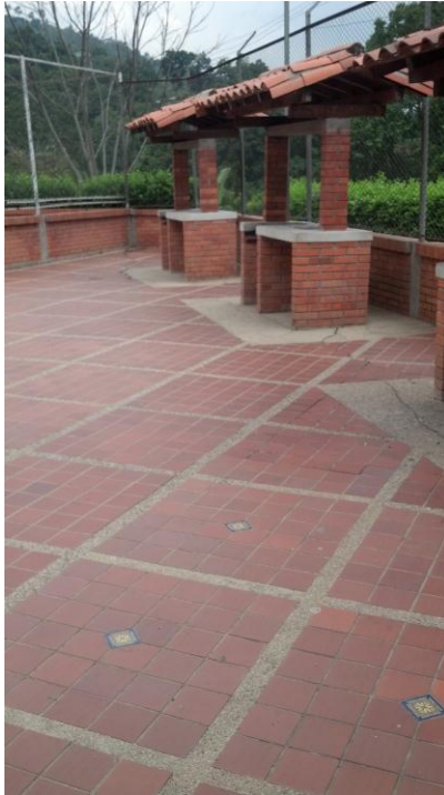
Foto 44. Zona de BBQ con fisuras en placa.
