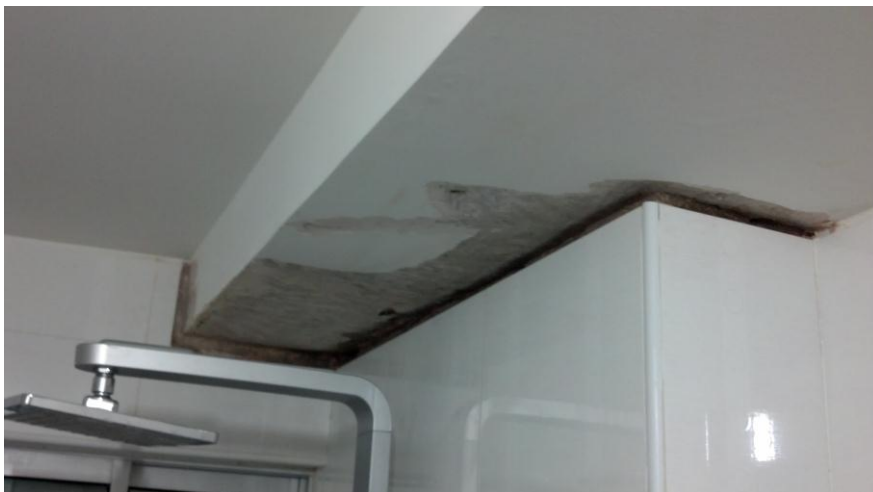
Foto 19. Humedad en placa descolgada del baño.
