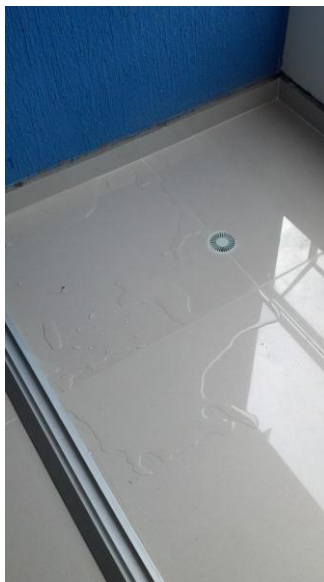
Foto 17. Empozamiento de agua en el piso del balcón.
