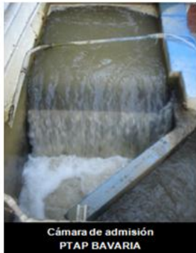
Fotografía 1. Cámara de admisión PTAP Bavaria S.A.
