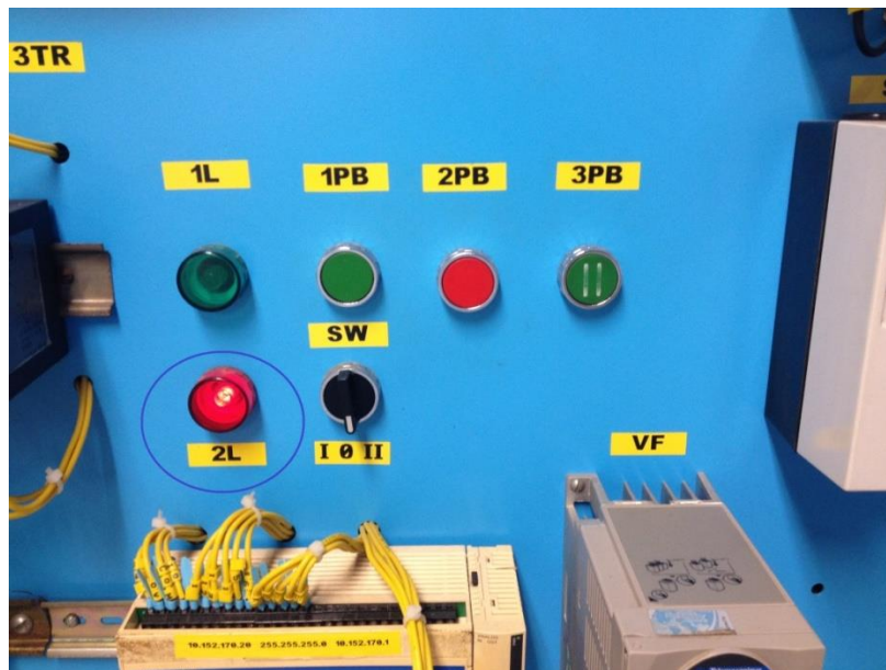
Figura 57. Alarma visual parado del proceso [46]
