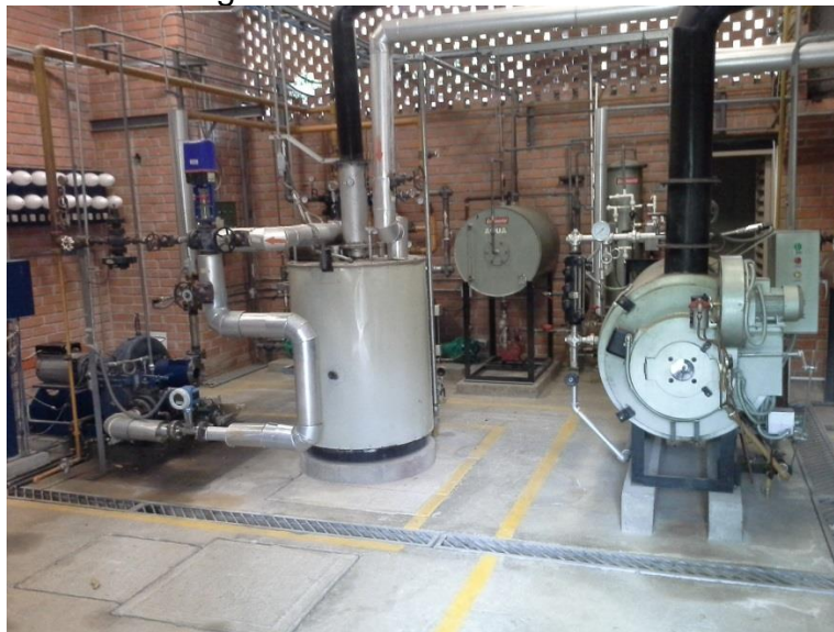
Figura 1. Planta Térmica UPB.
