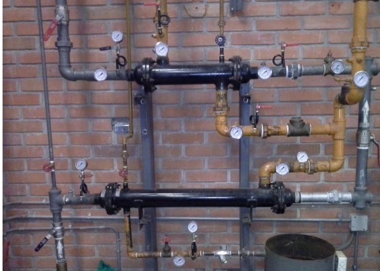
Figura 25. Intercambiadores de calor
