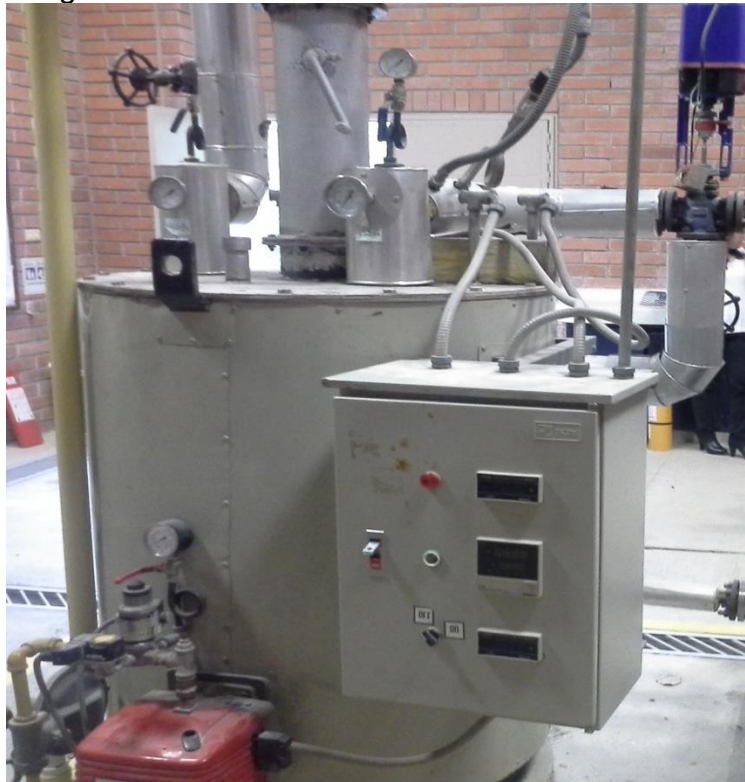
Figura 12. Sobrecalentador con tablero de control
