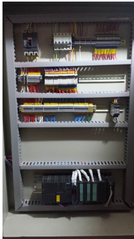
Figura 47. Gabinete eléctrico de control de la planta térmica UPB
