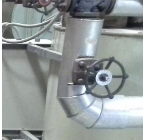
Figura 13. Válvula de control manual
