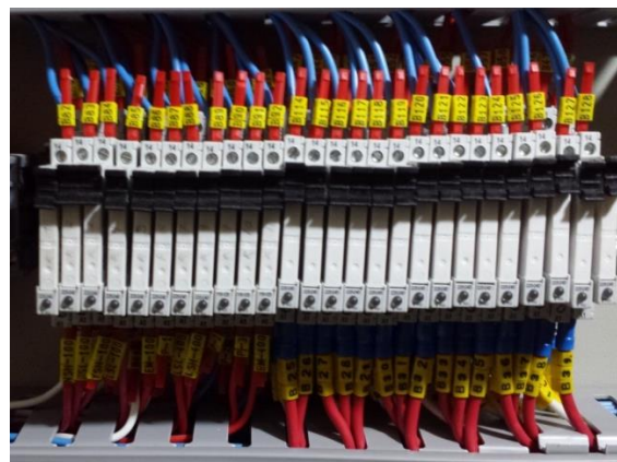
Figura 57. Relés electromecánicos de estado sólido planta térmica UPB
