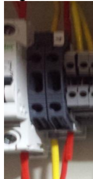
Figura 15. Bornas Portafusibles del gabinete de control de la planta térmica UPB
