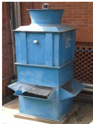
Figura 26. Torre de enfriamiento
