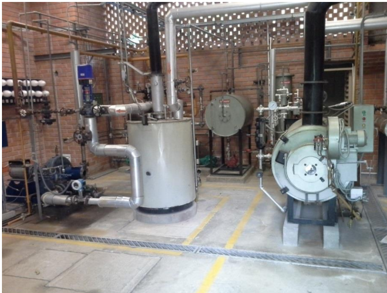
Figura1. Planta Térmica UPB
