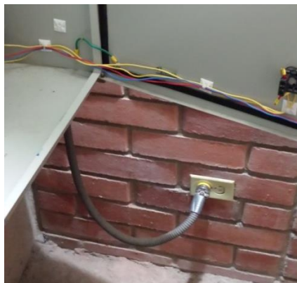
Figura 8. Conexión de Alimentación del tablero eléctrico de control
