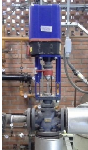
Figura 39. Válvula de tres vías con actuador eléctrico
