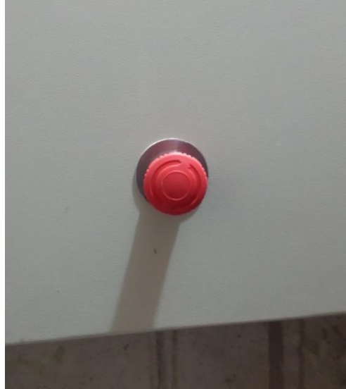
Figura 9. Parado de emergencia del tablero de control de la planta térmica
