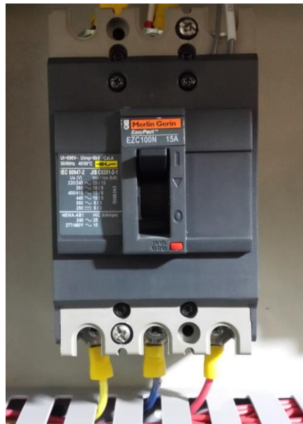
Figura 10. Totalizador del tablero electrico
