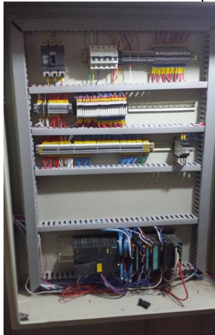
Figura 1. Gabinete eléctrico de control de la planta térmica UPB
