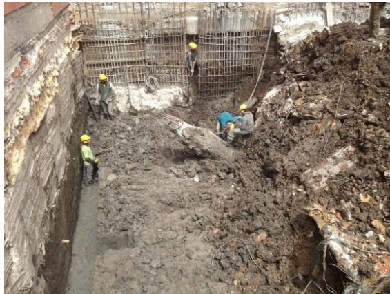
Fotografía 6. Pilote descubierto que presentó
