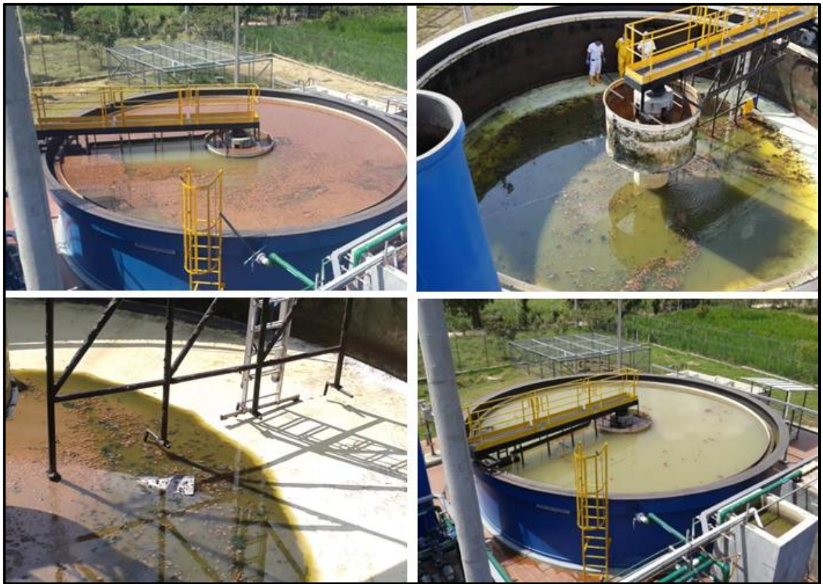
Figura 62. Bulking en el sedimentador secundario.
