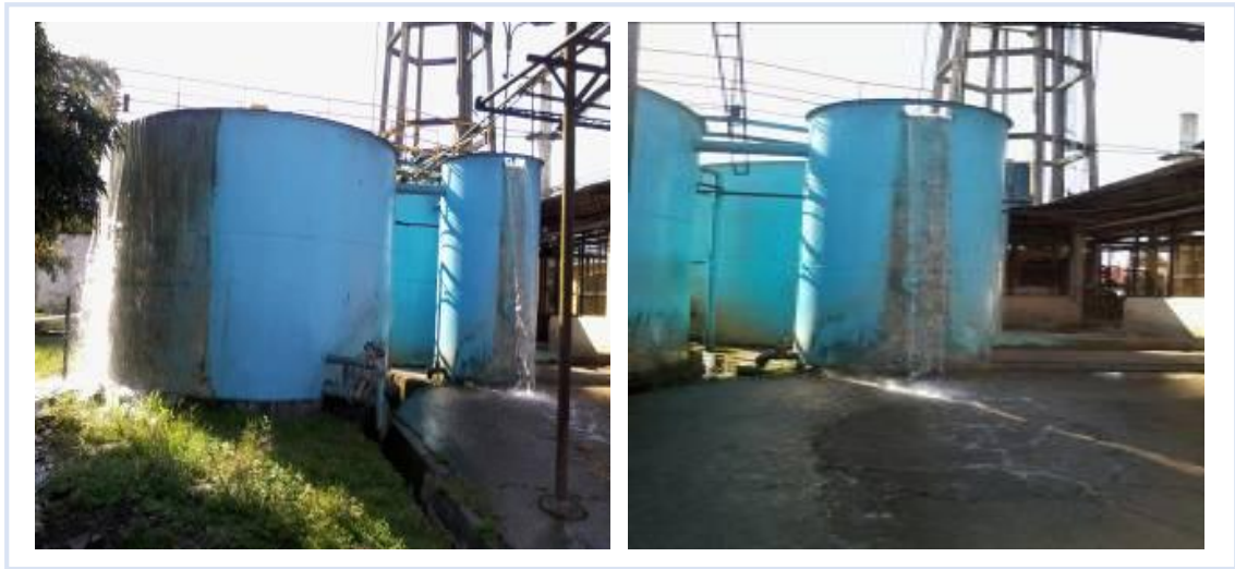
Figura 11. Pérdidas de agua en tanques de almacenamiento
