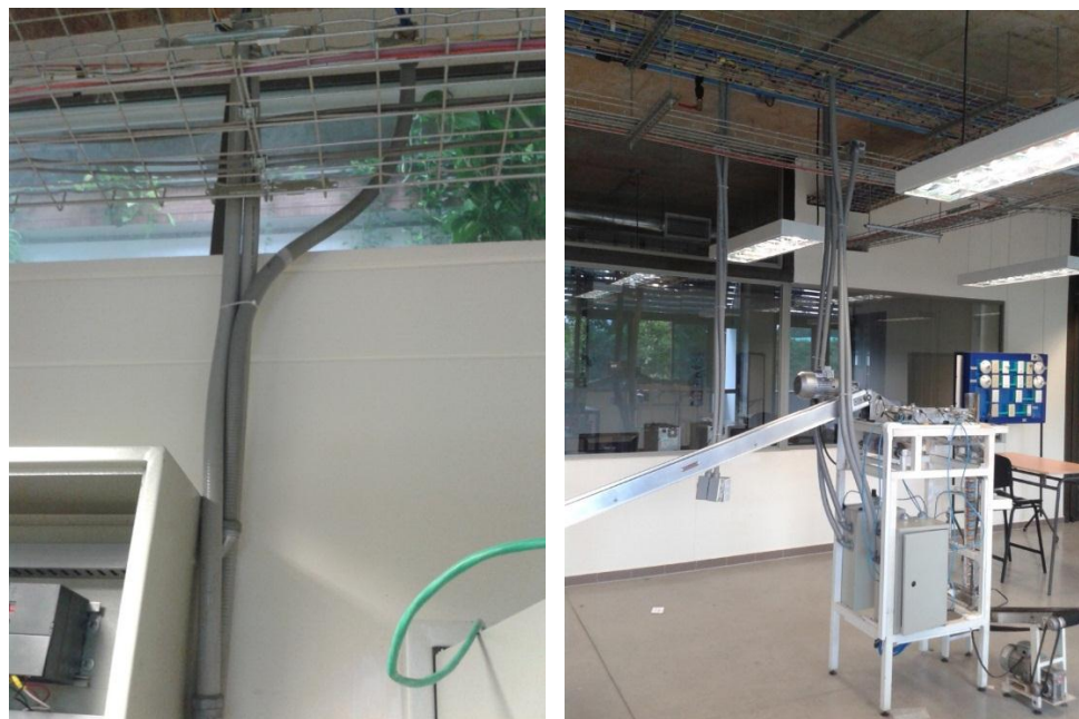
Figura 29: Cableado entre gabinete de control central (izq) y empacadora 2 (der) 35
