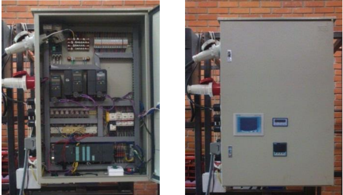
Figura. 27 Tablero eléctrico de control. 43
