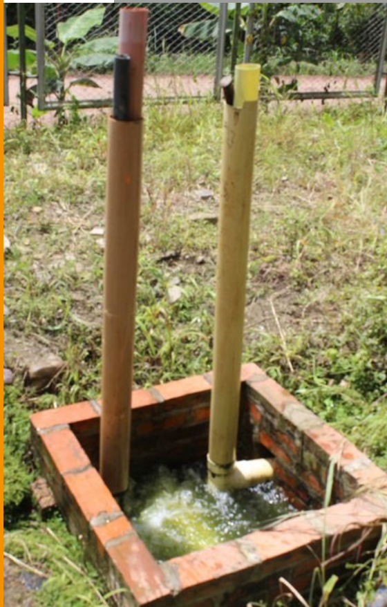
Foto 22. Estructura para limpieza y recirculación del agua de geomembranas.
