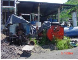
Calderas antiguas a base de aceite
