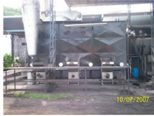
Caldera a base de carbón mineral
