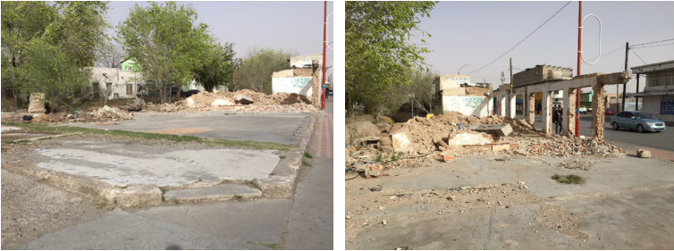
Figuras 4 y 5. Construcción en ruinas localizada en calle 16 de Septiembre (caso 11).
