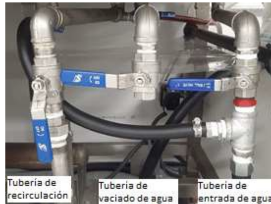
Figura 49. Salidas y entradas de agua del equipo
