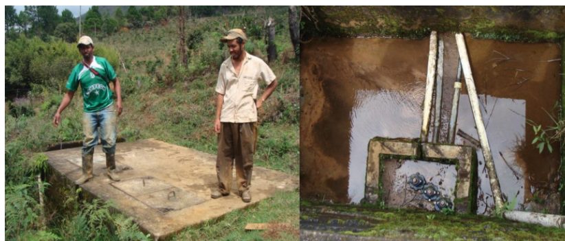
Tomado de: Diagnóstico y propuestas comunitarias para el mejoramiento integral del barrio (2013). Tanque distribuidor de agua del acueducto comunitario, en la derecha se muestran las válvulas de distribución para los sectores que surte: Altos de la Torre y Pacífico, Llanaditas y el Faro.
