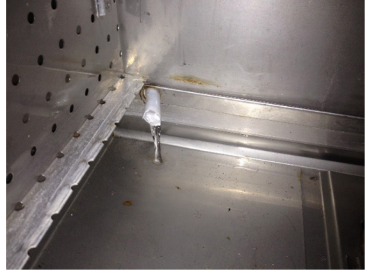
Figura 8. Llenado automático con válvula solenoide (parte superior Cámara de maduración).
