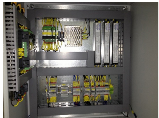
Figura 35. Gabinete cableado interno.
