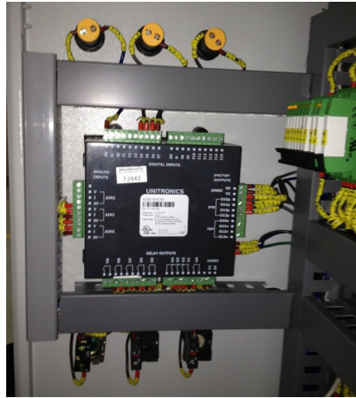
Figura 36. Gabinete cableado interno PLC.
