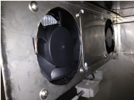
Figura 20. Ventiladores vista externa.
