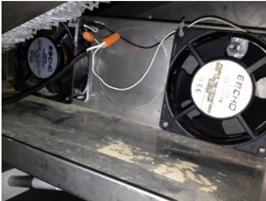
Figura 19. Ventiladores vista interna.
