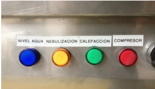
Figura 5. Indicadores luminosos instalados en la Cámara de maduración.
