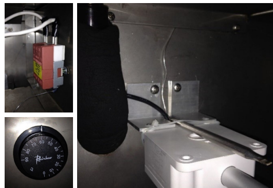
Figura 33. Termostato ubicado en la Cámara de ambiente controlado.
