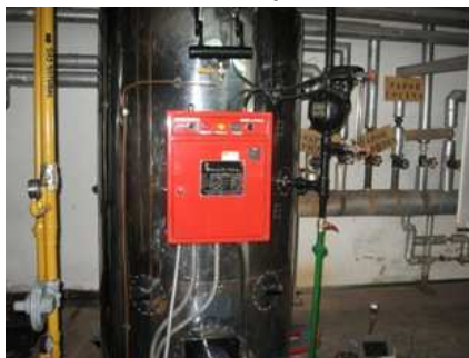
Foto 13: Tipo de caldera comúnmente empleada en clubes y centros deportivos
