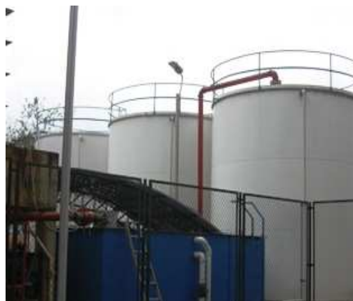
Foto 2: Tanques para la regulación y almacenamiento del agua
