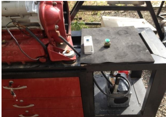
Figura 16. Conexiones eléctricas en el sistema
