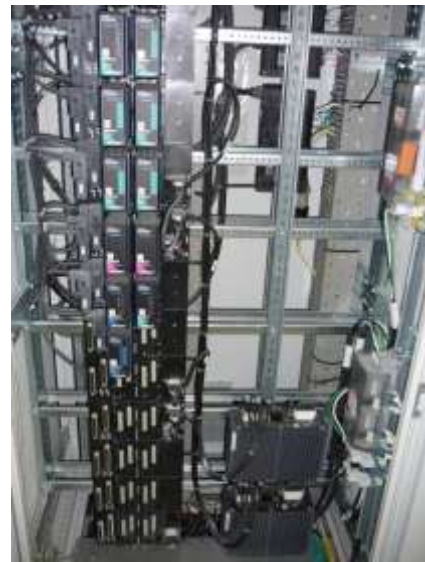
Figura No. 49 Gabinete E22500
