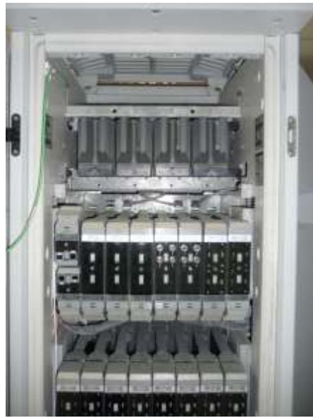
Figura No. 51 Gabinete E22700
