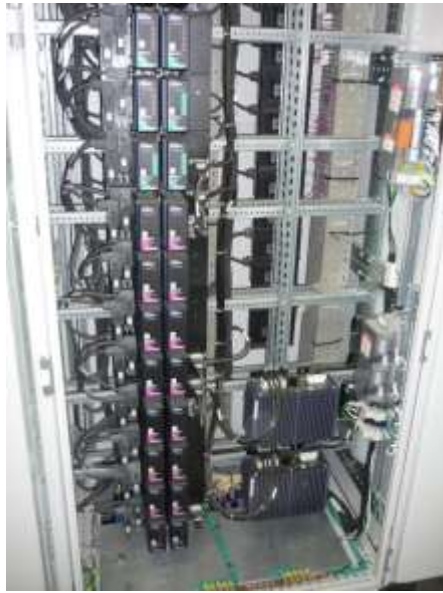
Figura No. 50 Gabinete E22501
