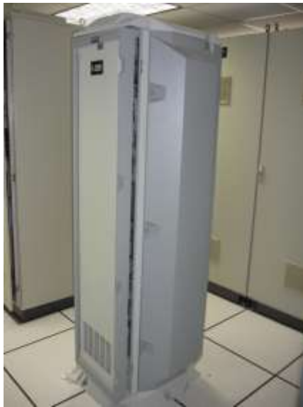
Figura No. 48 Gabinete E22201
