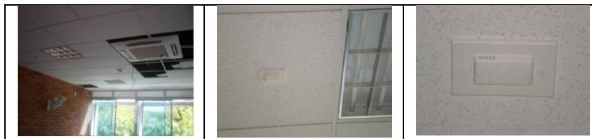
Figura 61. Ubicación del Sensor de temperatura Tipo 2 (10k) Termistor.
