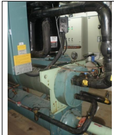
Figura 3. Refrigerante ubicado en el Chiller.
