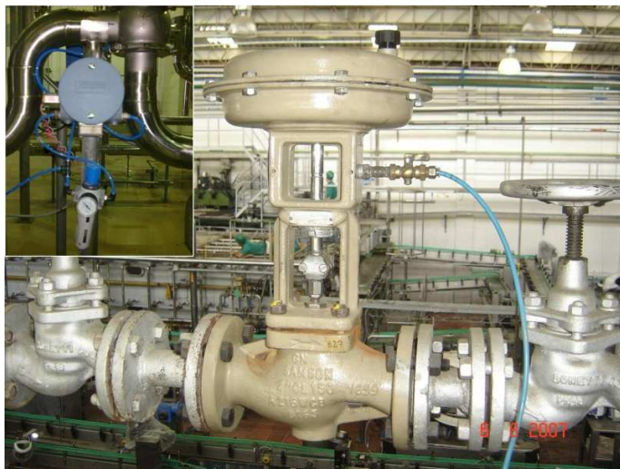
Figura 24. Válvula proporcional de paso de vapor samson con IP (interfaz de presión)
