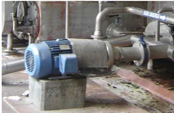
Figura 41. Bomba axial de adición de soda
