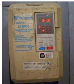
Figura 37. Variador de velocidad que controla el movimiento del motor principal
