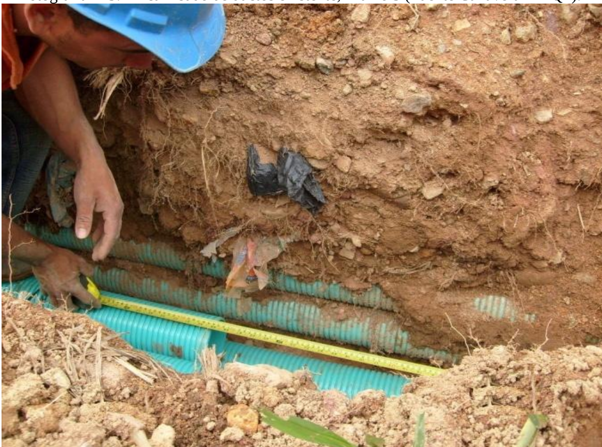
Fotografía #13. Encamisado de ductos existente, Tramo 3 (Puente Cañaveral – PQP).
