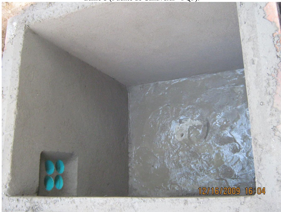
Fotografía #1. Placa de piso bajo el Puente Peatonal de Cañaveral, tramo 3 (Puente de Cañaveral - PQP).
