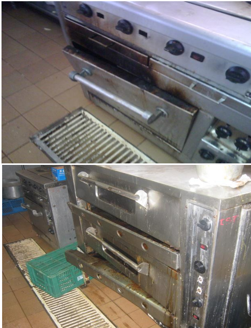
Figura 5. Estado de equipos de cocina.
