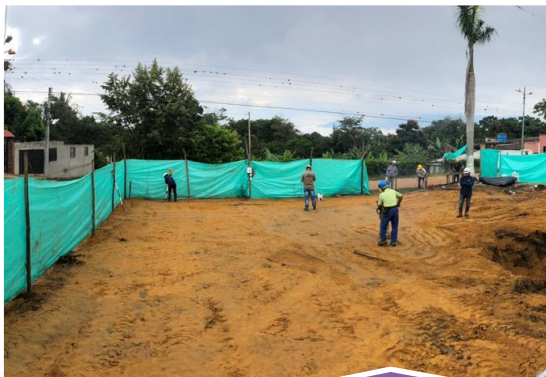
Rellenos compactados en material seleccionado proveniente de la excavación: Se rellenó todo el área a construir y se niveló el terreno con material excavado en obra.
