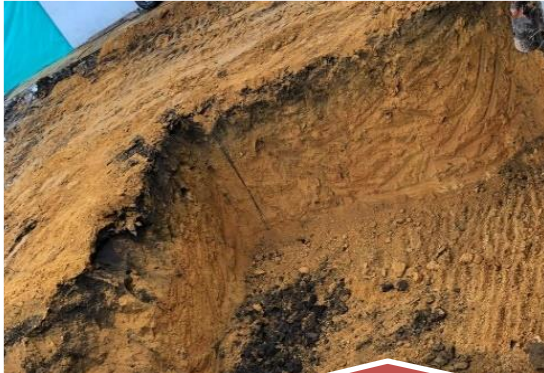
Excavación en material común: En esta imagen se evidencia la excavación del tanque de almacenamiento, pero también incluye excavaciones de zapatas, vigas de cimentación, etc.
