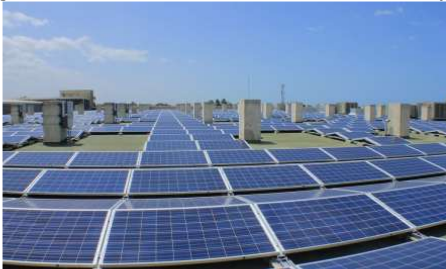
Figura N° 15. Planta fotovoltaica, Centro Comercial Viva Wajiira
