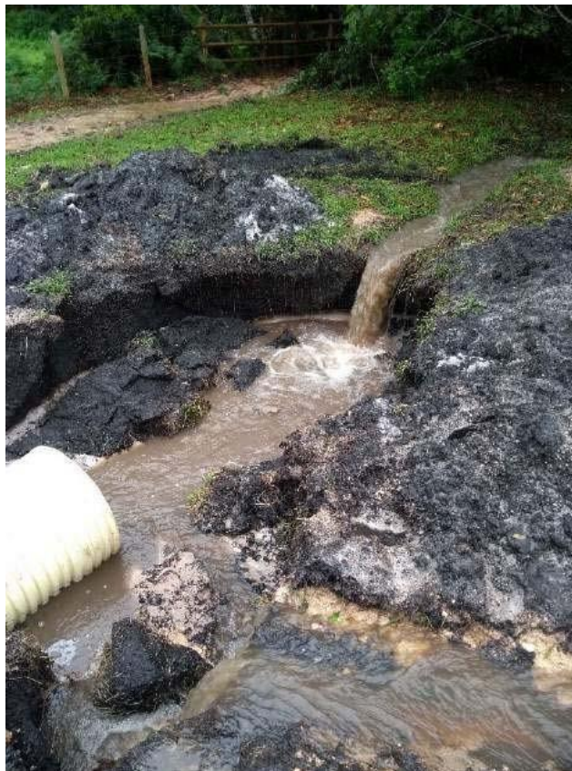
Figura 34-Excavación destruida por fuerzas naturales
