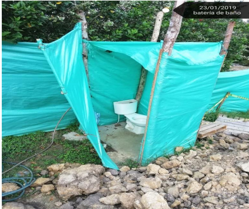
Fotografía 2. Batería de baño
