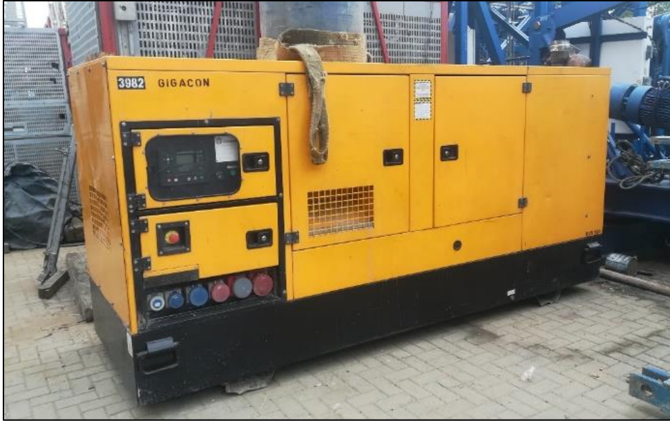
Figura 20. Grupo electrógeno GESAN 220 – 200Kva – Fuente: Autor.
