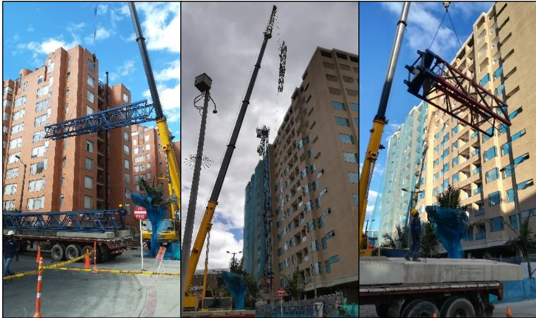
Figura 24. Descargue de piezas torre grúa COMANSA 5LC 5211, Bogotá D.C. Fuente: Gigacon Transportes S.A.S.
