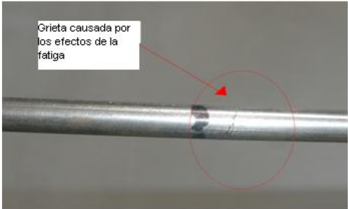
Figura 34: Visualización de la grieta causada por fatiga
