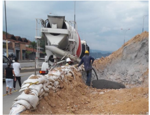
Imagen 37. Desperdicio de material por recalentamiento de la bomba de concreto
