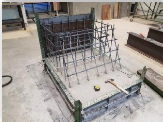
Fundida de la base del muro
