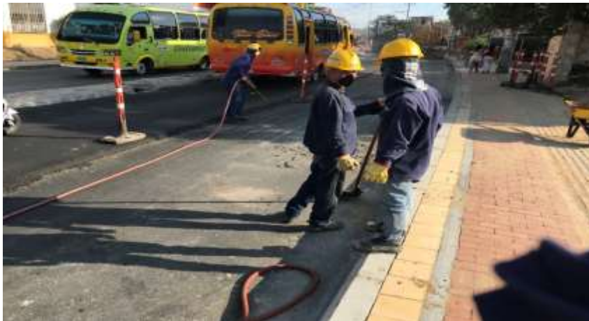
Imagen 17. Limpieza con manguera del compresor
