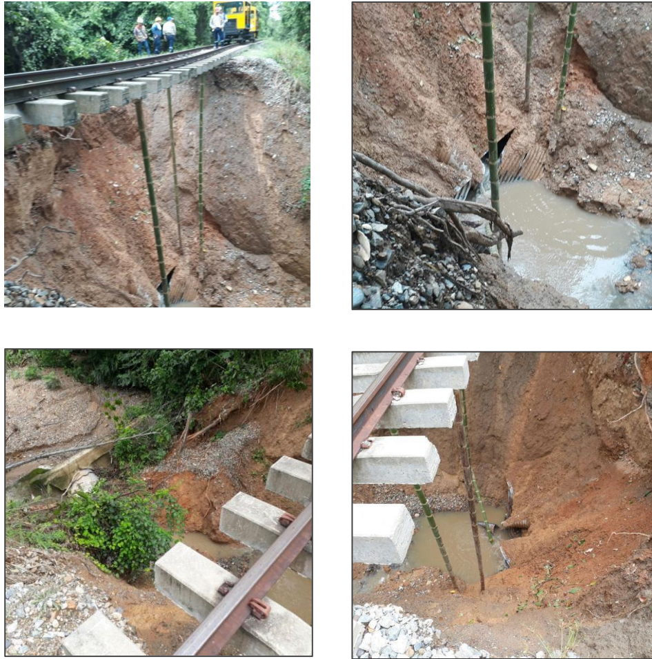
Figura 5. Punto crítico PK 238+ 000
