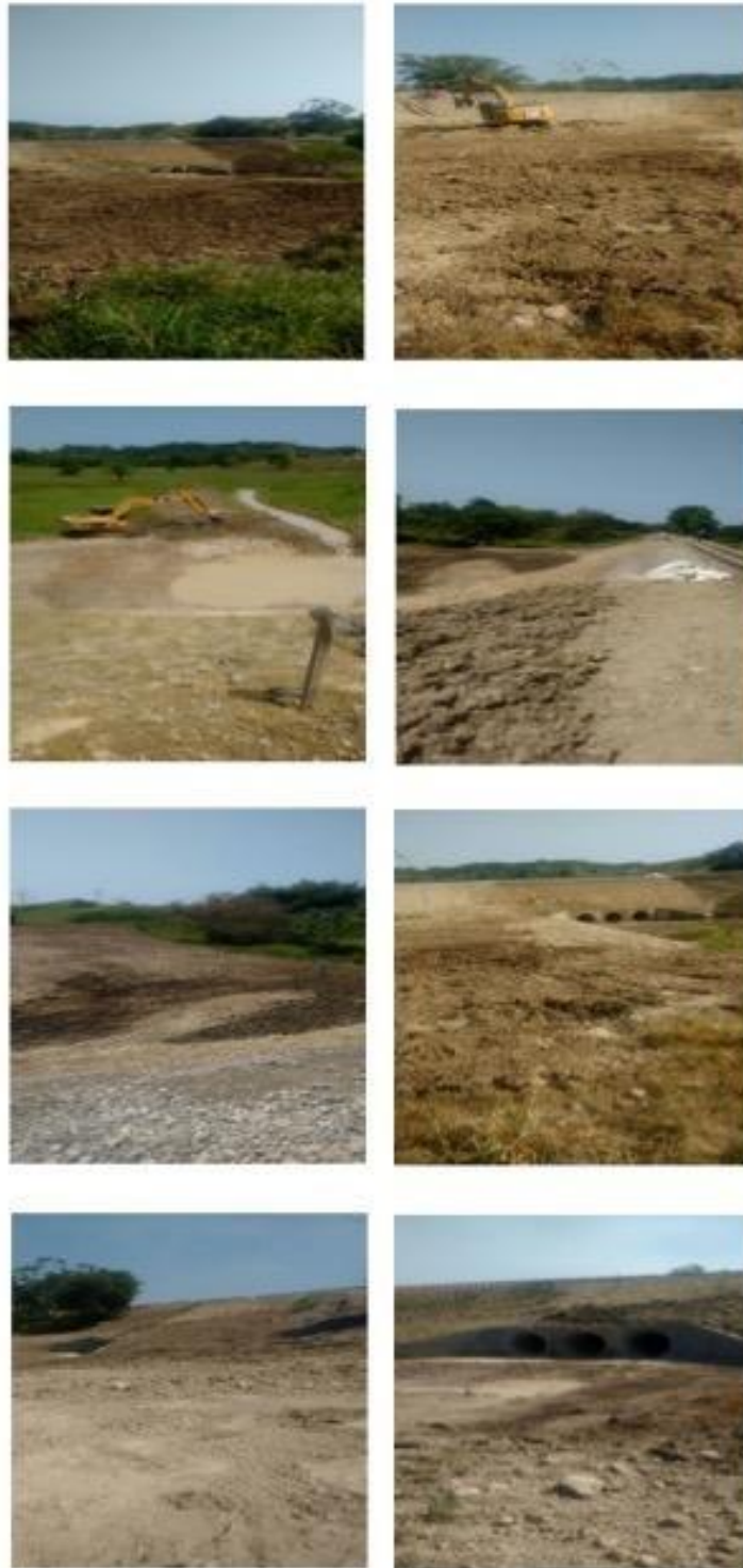
Figura 13. Punto Crítico PK 358 + 100
